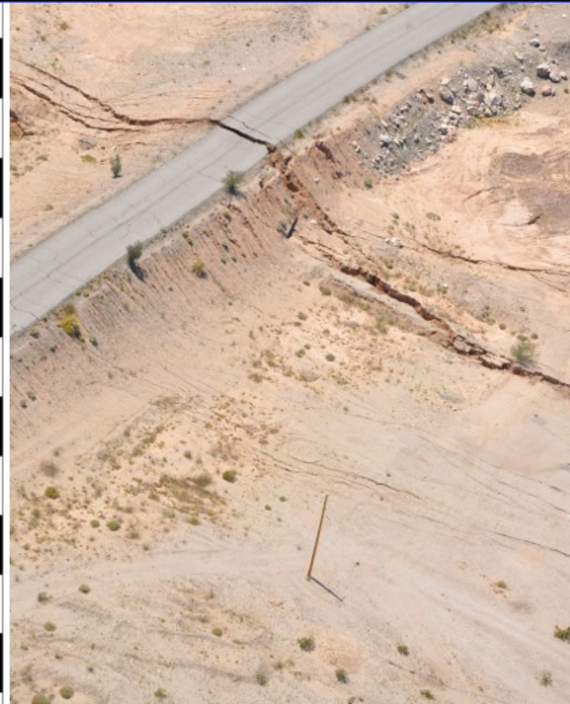
Faulted Highway (K. Hudnut)
